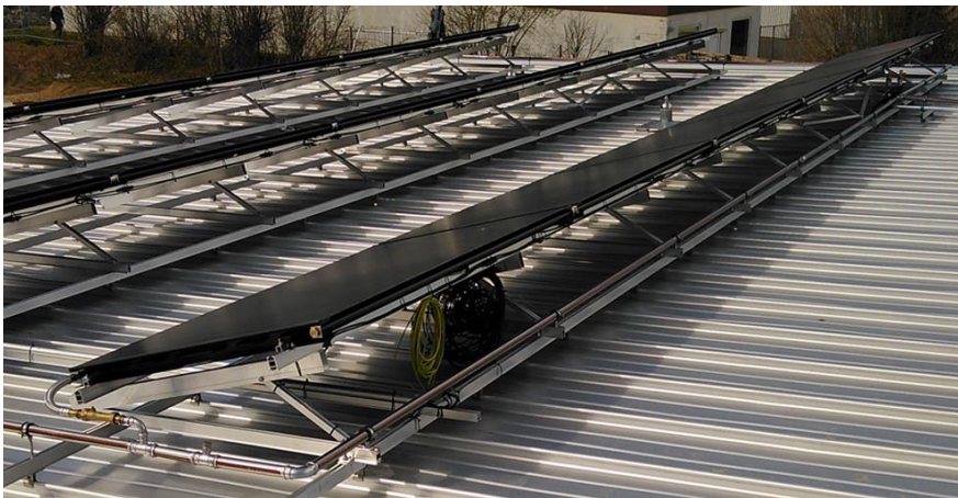
Abbildung 24: PVT-Anlage auf dem Dach der Feuerwehrrache
